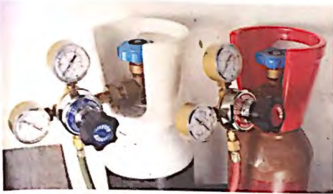
▲ Válvulas de apertura y cierre y manureductores.
