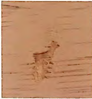
124. Zona dañada del tablero.
