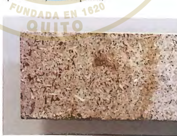
75. Marcas ocasionadas por la humedad.
