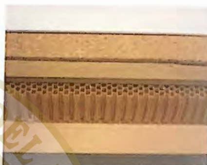
212. Forrado con papel sobre una capa de intervención realizada con una lámina de corcho.
