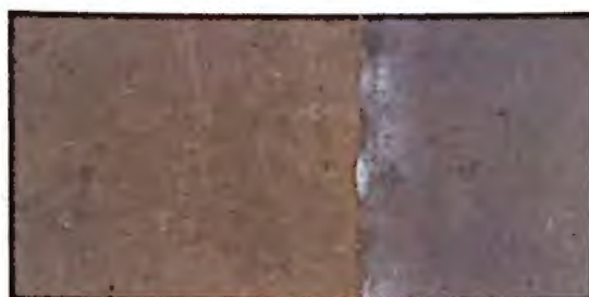
84. Alteraciones producidas por la acción de la humedad.
