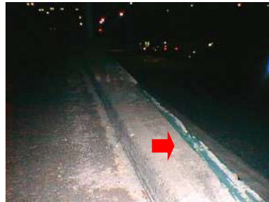
Huellas de pintura.
