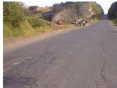
Calzada asfaltada seca irregular (baches).
