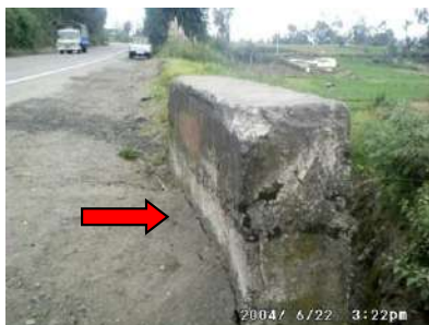
Punto de impacto sobre muro de concreto
